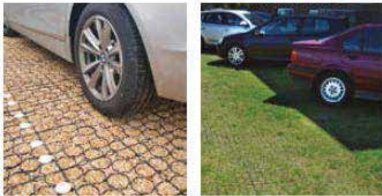
Figure 2 - Les GV installées
